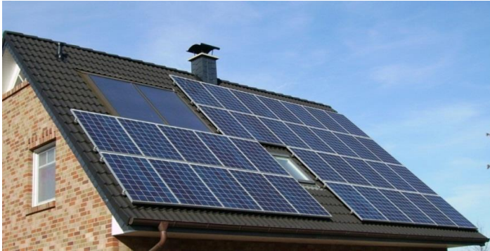
Gambar 5.12 Panel Surya sebagai Sumber Energi di Rumah
