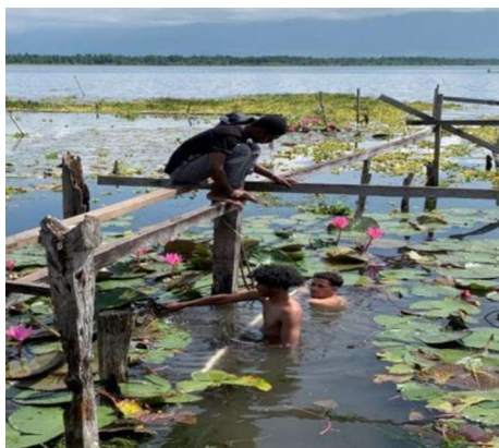
Gambar 4. Instalasi Perpipaan dari sumber air Danau Sentani
